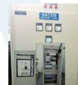
Création des produits SACEM POWER SYSTEM Tableaux MT et BT
